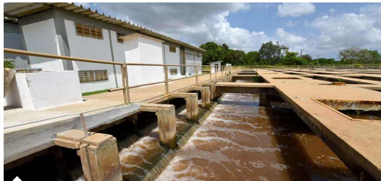
Entrada da recirculação da água da lavagem dos filtros na ETA Gavião, onde receberá novo tratamento
