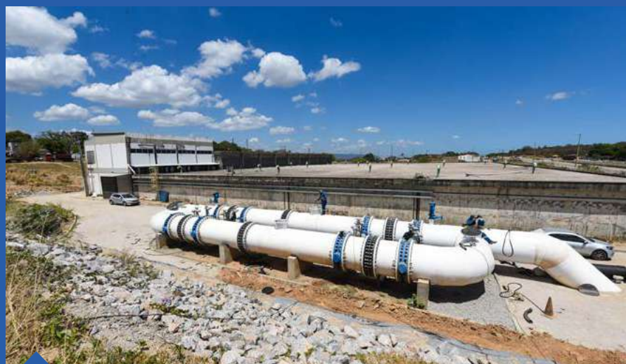
Estrutura de by pass que ajusta a distribuição da água para Fortaleza em termos de pressão
